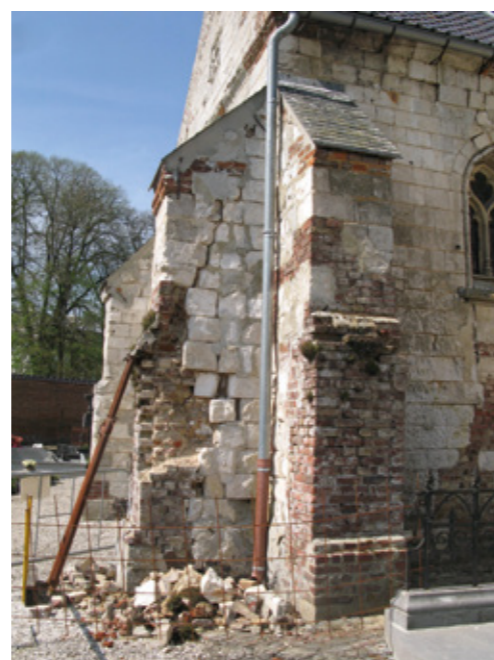
6. Désordres du transept sud
