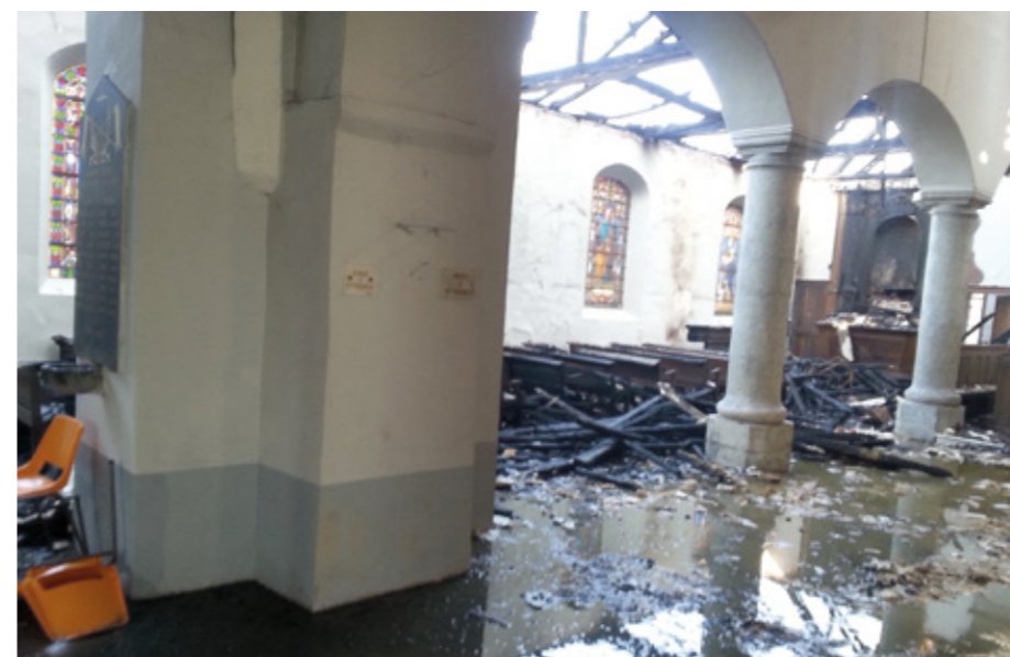
5. État de l'intérieur après l'incendie
