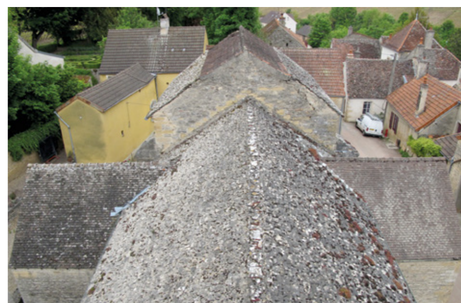
6. État de la toiture avant restauration
