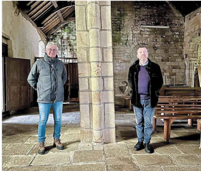
À Confort-Meilars, les habitants et associations constatent que les colonnes de l'église Saint-Mélar penchent.
