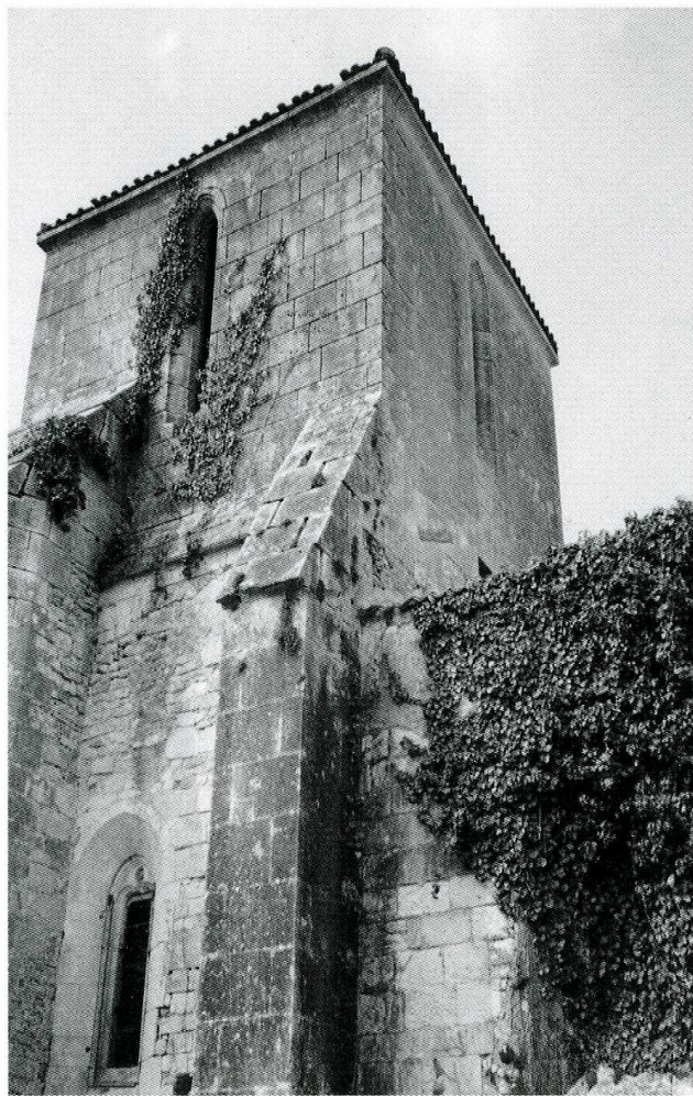
Saint-Sever-de-Saintonge (Charente-Maritime). Le clocher de l'église avant restauration.
