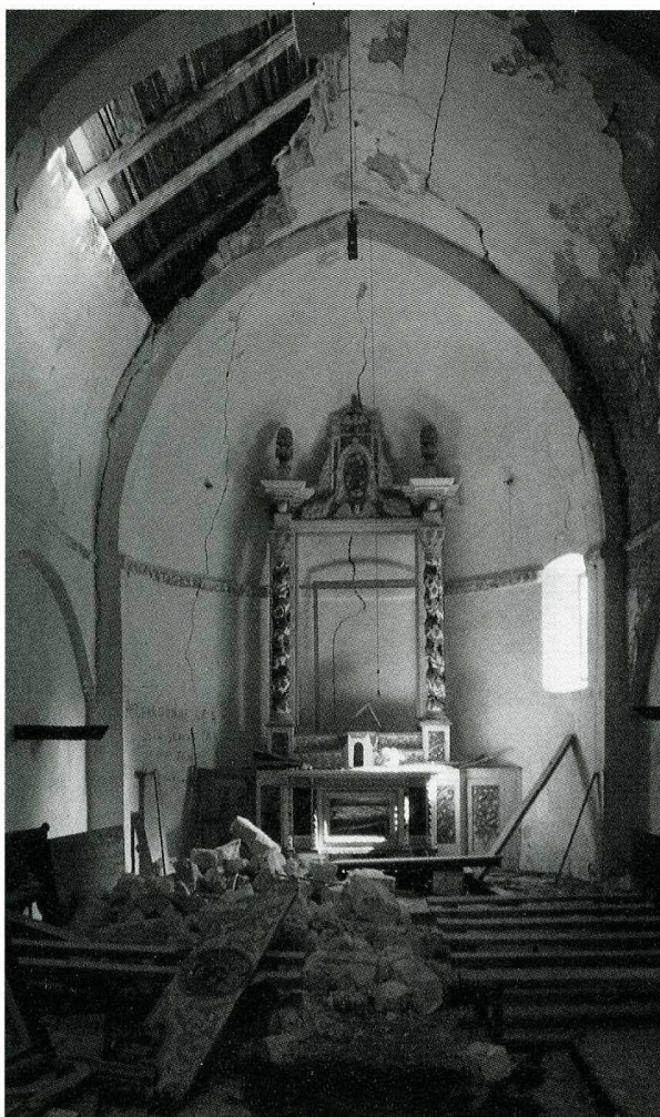
Thorame-Basse (Alpes-de-Haute-Provence). Chapelle Notre-Dame de Piégut, l'intérieur avant travaux.
