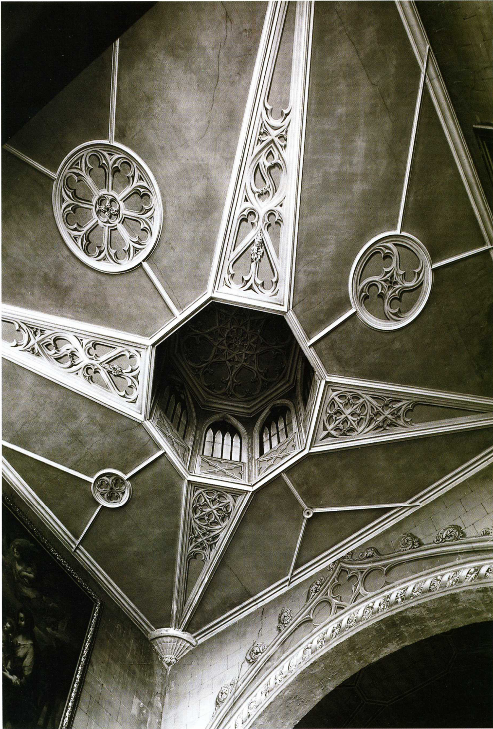
Villeneuve-lès-Avignon (Gard), Chapelle de l'ancien hospice. Le plafond de la nef avec le lanternon (cl. Daspet)
